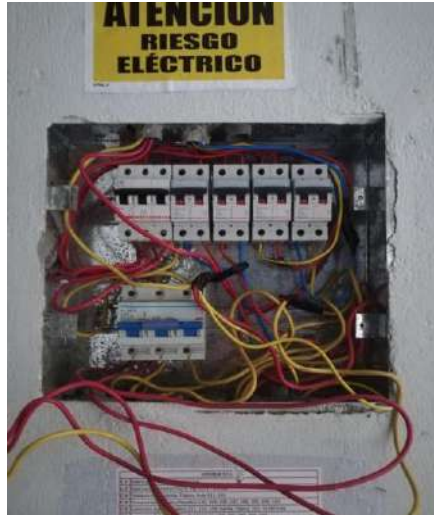
Imagen 01: Detalle actualmente de tablero eléctrico, solo se puede considerar una capacidad de potencia contratada de 5.30kW, potencia insuficiente para los nuevos equipos de laboratorio.
