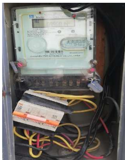
Imagen 03: Caja de medidor, se requiere de un nuevo buzón para el traslado de nueva terna de cables de mayor potencia.
