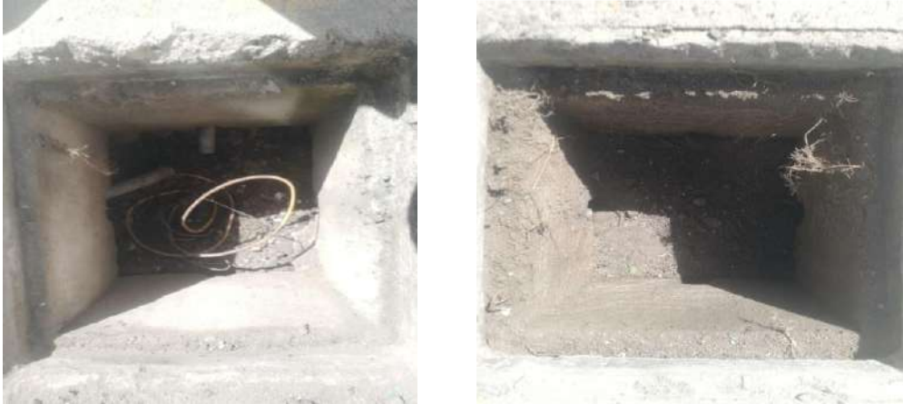
Imagen 08: Detalle de Puesta a Tierra N° 01 y N° 02
