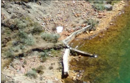
Fotografía N° 17.- Vista de los muros de encauzamiento en la entrada del túnel de descarga
