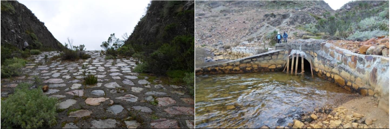
Fotografía N° 33: - Condiciones actuales del dique artificial en la laguna Tullparaju. Fotografía N° 34: Vista de la entrada del túnel de descarga.
